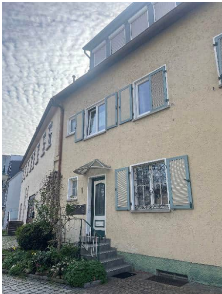
Abbildung 24 Gebäude mit substanziellen Mängeln, Äußerer Schosshof (Quelle: WHS, 2024)
