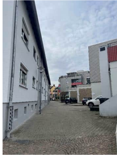
Abbildung 34: Uneinheitlicher und defekter Straßenbelag auf einigen Straßen sowie unübersichtliche Wegeverbindungen (Quelle: WHS, 2024)
