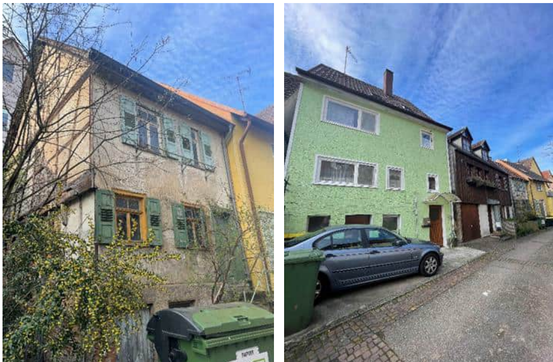
Abbildung 23: Gebäude mit schwerwiegenden Mängeln und weitere modernisierungsbedürftige Gebäude in der Grabenstraße (Quelle: WHS, 2024)
