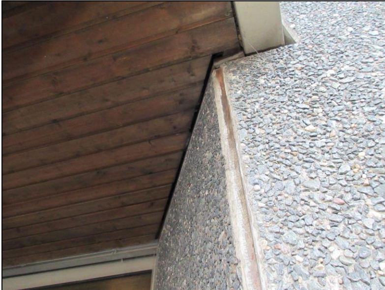
Abb. 8: Spalten im Bereich der Terrasse
